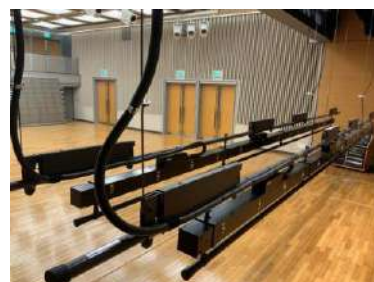
照明バトン／吊荷重400kg
